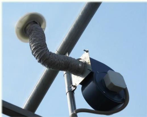
Система подачи воздуха в межпленочное пространство.
